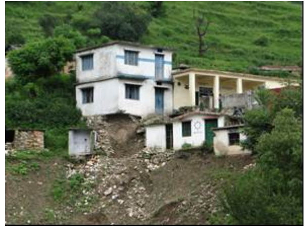
ग्राम उडरी में कृषिभूमि में दरारों में अवतलन ( subsidence ) की स्थिति ।
